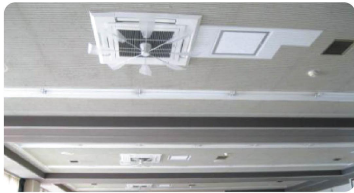
天井タイプ (2階第1・2研修室に3台)
